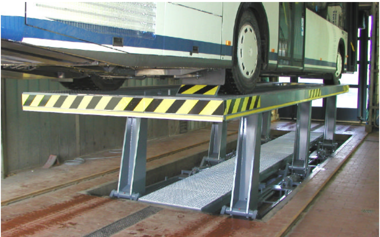
STARR E 15 MHR als Waschbühne bodeneben eingebaut
